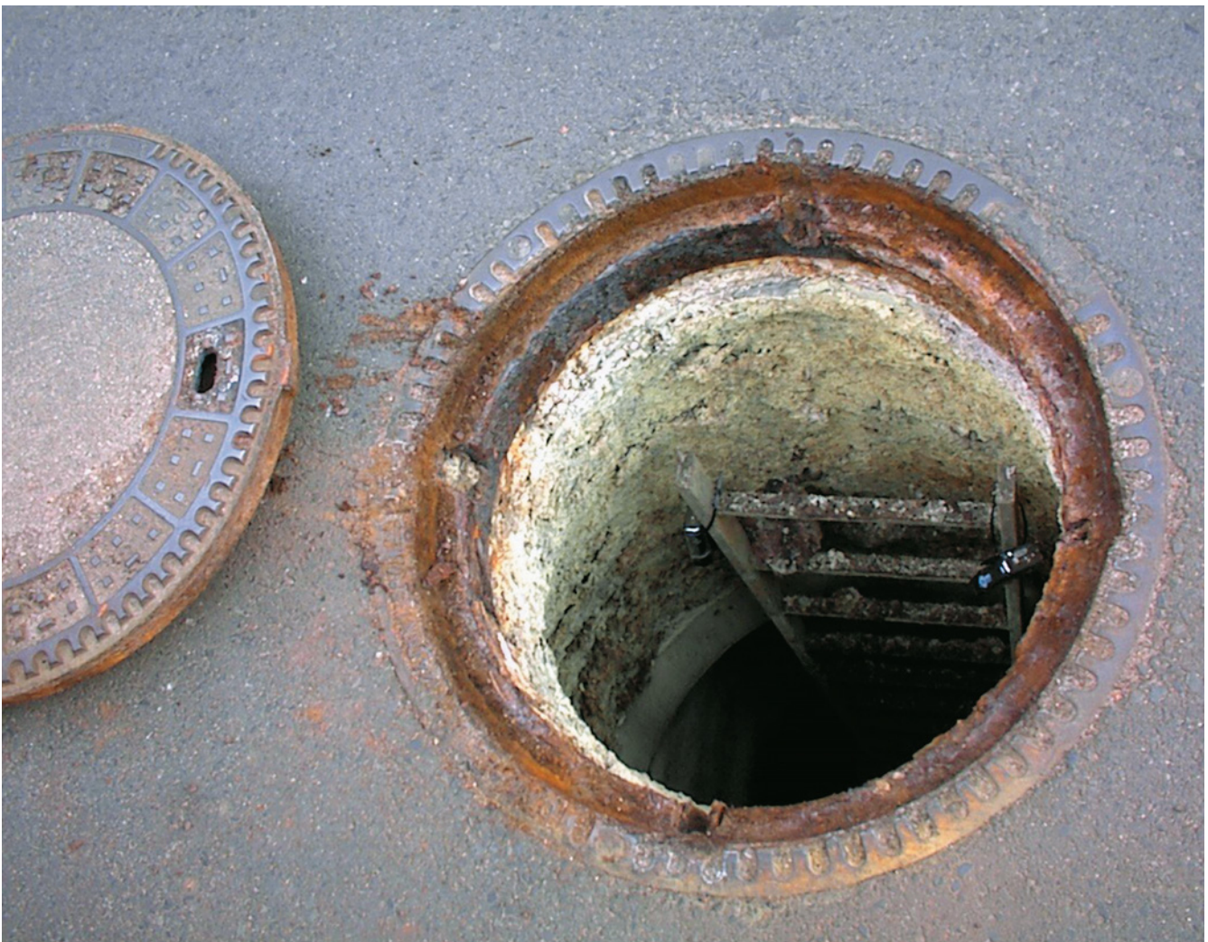
Schäden in einem Kanalschacht durch biogene Schwefelsäurekorrosion (BSK)
