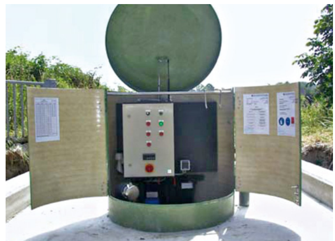
Abb. 3: Dosieranlage im Domschacht
