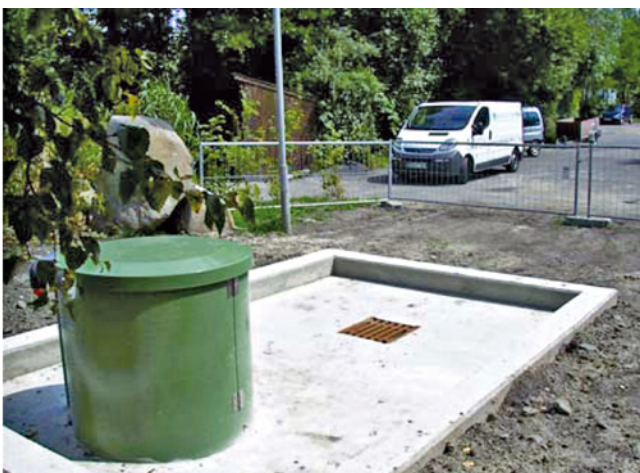
Abb. 2: Unterirdischer Tank am Pumpwerk mit WHG-konformer Auffangwanne
